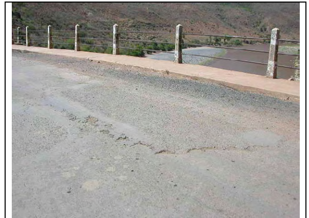
写真 2.1.6 橋面舗装の損傷
