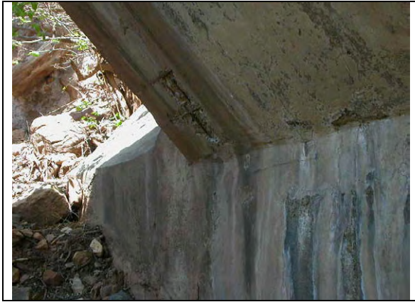
写真 2.1.3 アーチ部鉄筋露出
