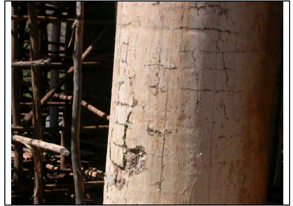
写真 2.1.4 側径間橋脚損傷
