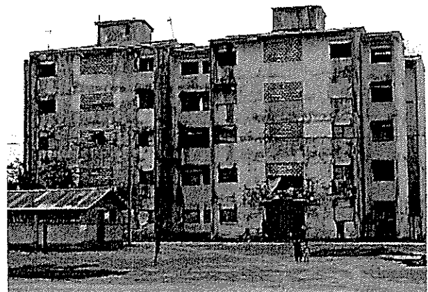
国家住宅開発省により建築された5階建て住宅も、銃弾を受けて破壊された。人は住んでいるものの、電気、水道は使えない状態である。
