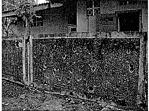
民家の壁も弾痕だらけである（ジャフナ市内）。
