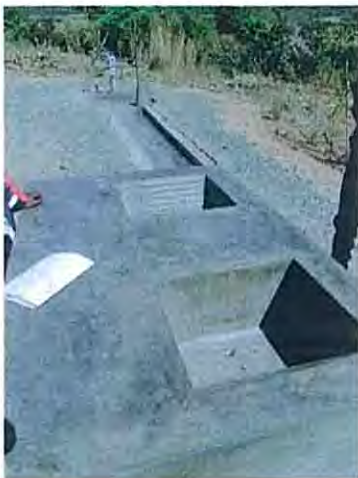
マラウイの給水施設標準設計は、バケツを頭に乗せるのを容易にするスタンドと洗い盆付き。洗い盆の洗濯板は日本の工夫。
