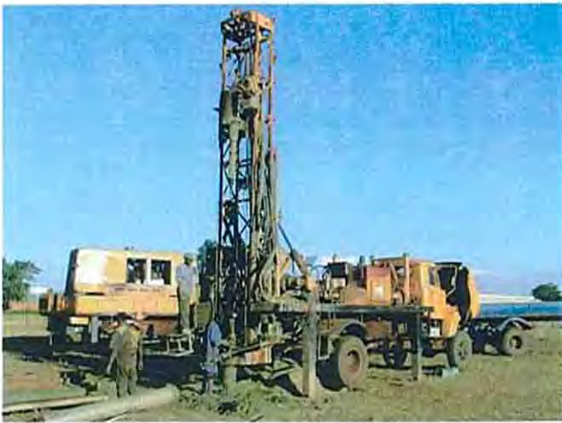
89年「北カウインガ地区地下水開発計画」で調達された日本製井戸掘削機。リロングウェ市内の学校敷地内で掘削作業中。
