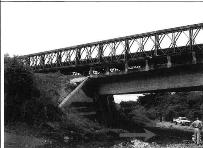
③ ラス・オルミガス橋：(左がニカラグア方) ニカラグア方面の橋台が洗掘によって陥没した。
