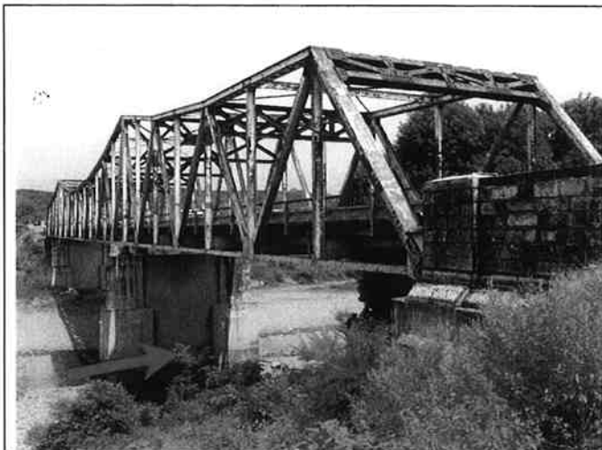
① グアシロペ橋：(ニカラグア方を望む) 3径間連続トラス下路橋、橋長 158m
