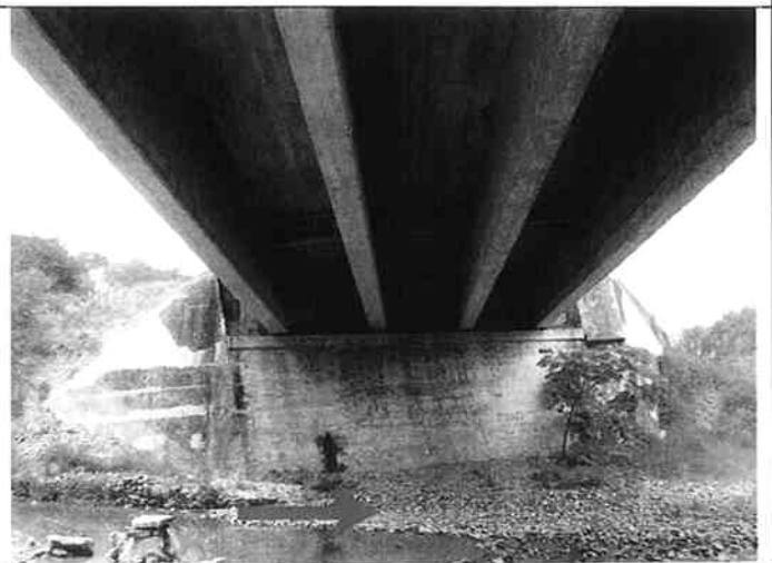
③ ラス・オルミガス橋 (ニカラグア方を望む) 洗掘によって上流側に傾いた橋台。
