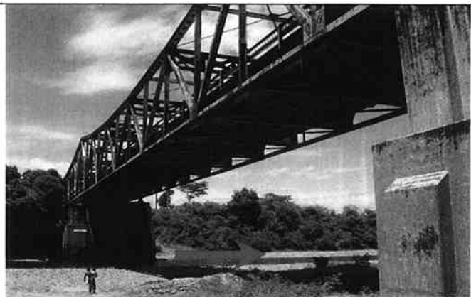
① グアシロペ橋：(ニカラグア方を望む) 下部工は強固のようである。
