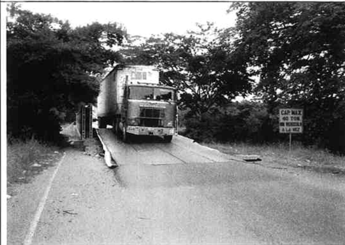
③ ラス・オルミガス橋：(ニカラグア方を望む) 重量制限 40 トンのサインボードが見られる。
