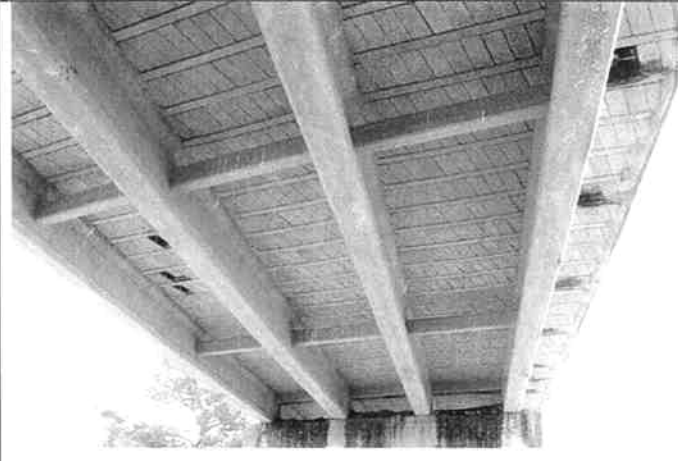
② ナマシグエ橋：(ニカラグア方を望む) ブロックの脱落が見られる。
