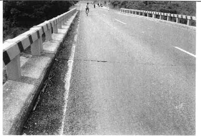
② ナマシグエ橋：(ニカラグア方を望む) 橋脚上の目地割れが見られる。
