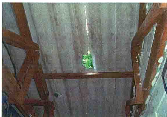
屋根の破損状況
