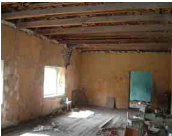
危険な状態の教室内部
