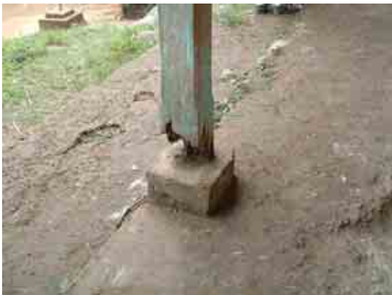
老朽化した柱
