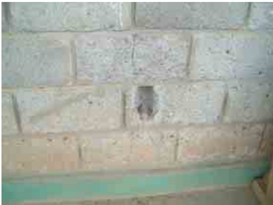
破損したコンクリートブロック
