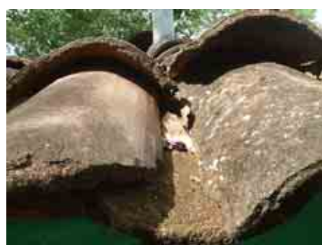
強度不足のため風化の進む瓦
