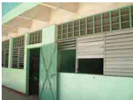
鋼製ドアと破損したアルミルーバー窓
