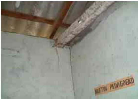
教室内部の壁クラック
