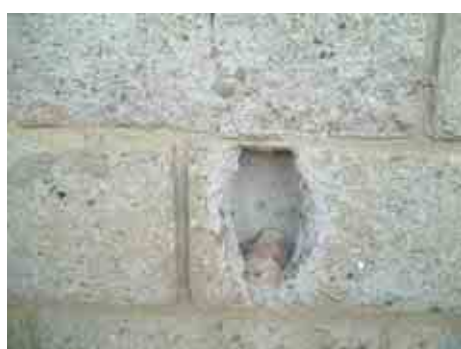
強度不足でひびが入り穴の開いた CB
