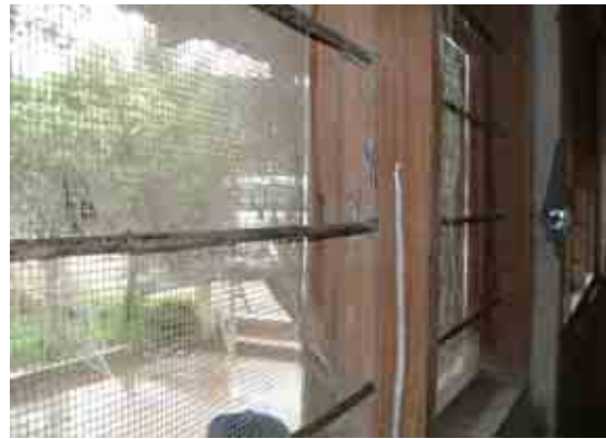
開口部ネット破損状況
