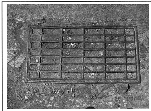
ALCANTARILLA TUPIDA TRAMO 1 CALZADA DE CONCHA Y LUYANO
