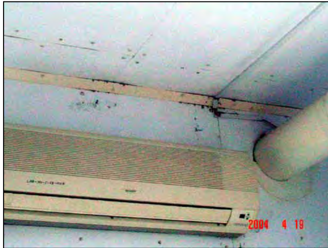
写真 カビが繁殖している壁、天井
