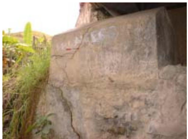
甚大なクラックが生じている橋台。
