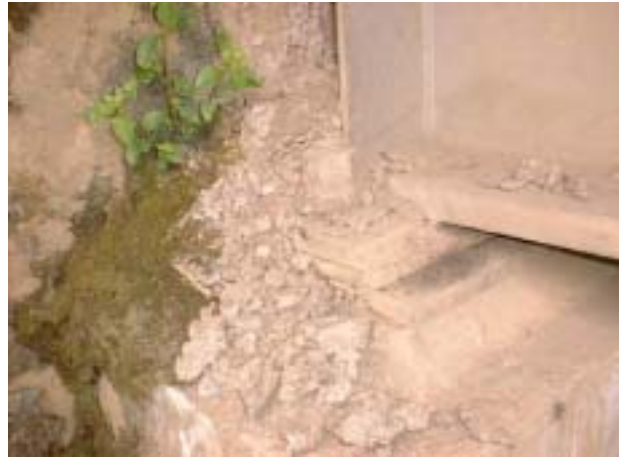
土砂が堆積した沓座。
