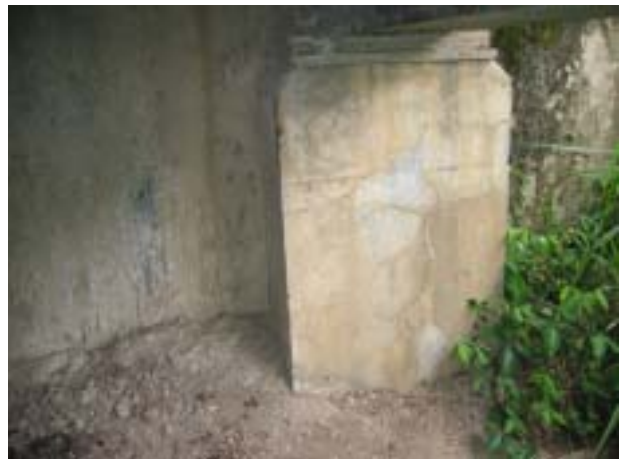
著しいクラックが見られるパイルベント式橋台。
