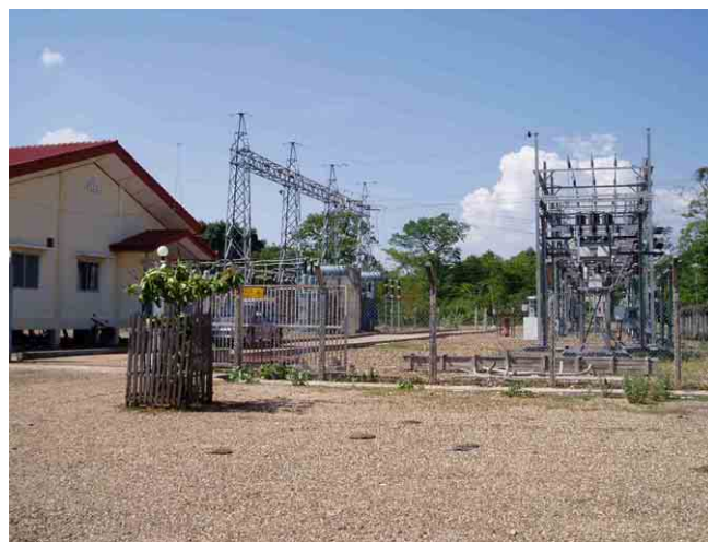
パクボ変電所
