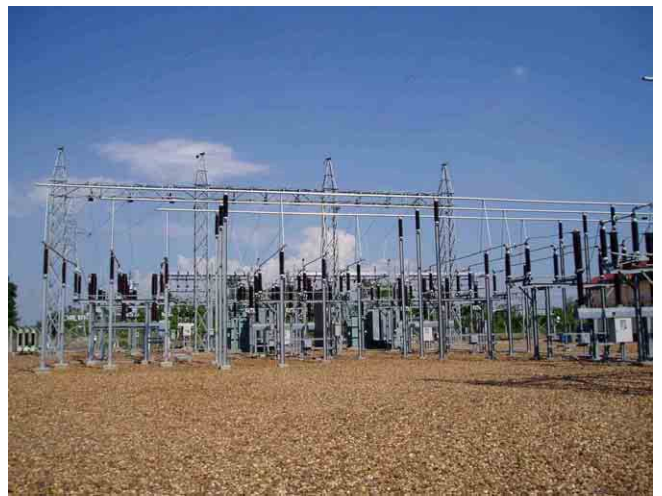
パクボ変電所
