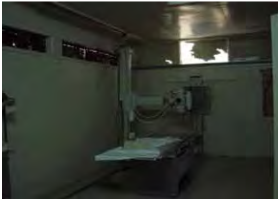
レントゲン室(防護壁がない)
