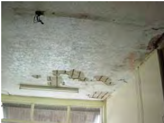
病室天井のコンクリートの剥離
