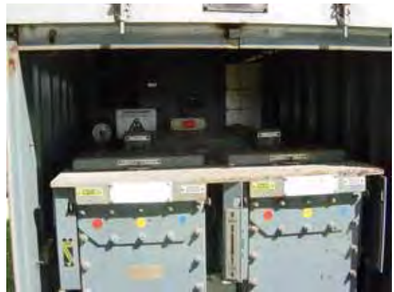
300KVA 変圧器(500KVA に更新)
