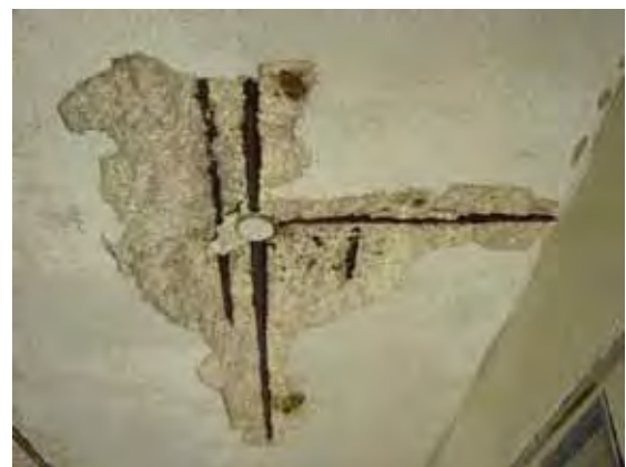
渡り廊下のコンクリート剥離(電気配管と鉄筋)
