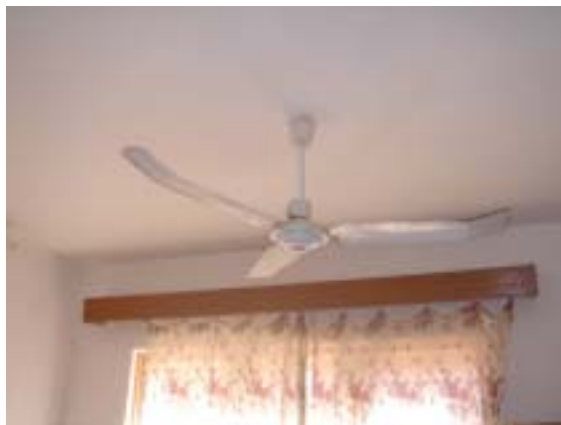
天井扇風機 (秘書室)
