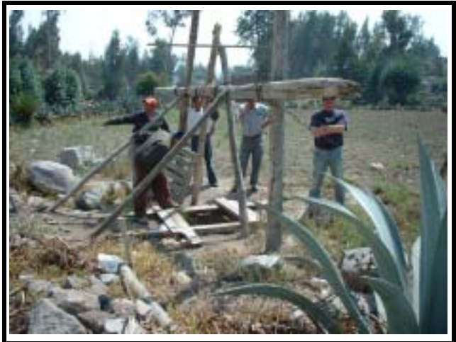
サンマルティンデベラニージョ (No.2) 村民による浅井戸の掘削場所。結果は空井戸であった。
