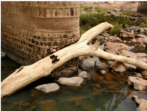
流木により橋脚一部が損壊を受けている
