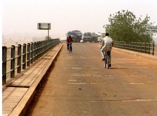
写真 5.2 同左の路面状況
