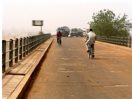
写真 5.2 同左の路面状況
