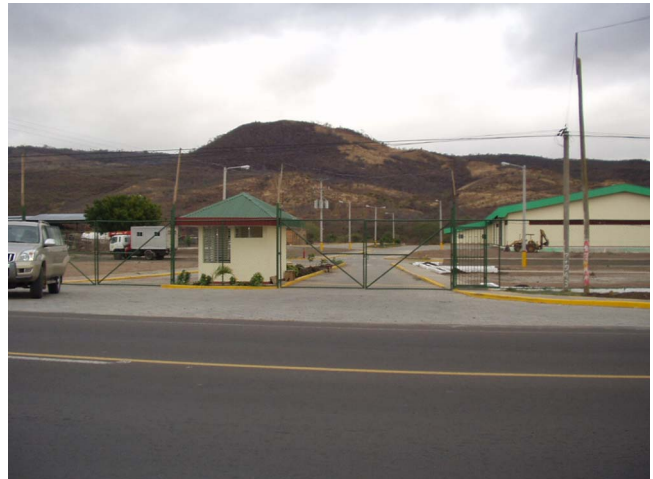
Sebaco(首都マナグアから約 100km 北)に建設中の中央整備工場(左手)、来年には完成予定。右の完成棟は肥料用ウエアハウス
