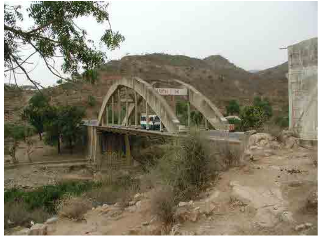
既設ギンダ橋（マッサワ側から望む）
