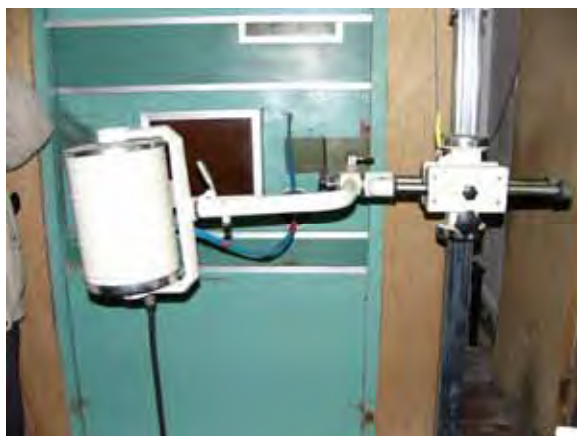
母子保健サービスセンター X線検査室：既存機材（X線透視撮影装置）
