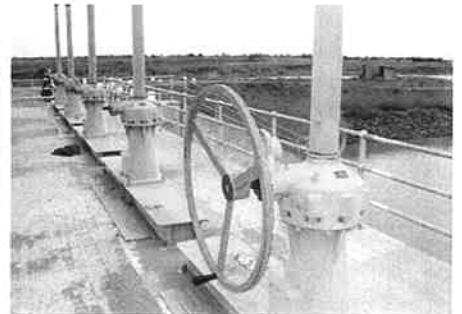
6 同左 ローラーゲート操作部
