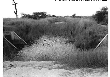
6. 1次給水路末端：手前左右は2次給水路への分水工
