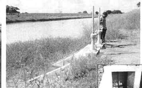
10 流入工 ゲート (下部はゲート部)
