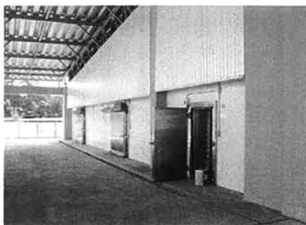
13.卸売市場 冷凍庫、冷蔵庫入口
