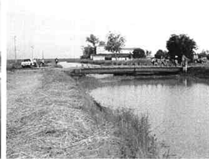
5 1次給水路現況：土砂堆積により河床が上昇し橋桁下ゆとり減少
