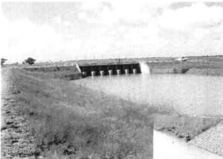
4 水位調節堰 (下部写真は 法面一部洗い 出し箇所、及びレギュレーター上流部)
