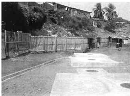
44.浄化槽、浸透弁
