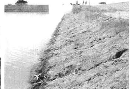
9 同左左岸側下流部 法面、洗い出し 発生箇所 (補修決定済み)
