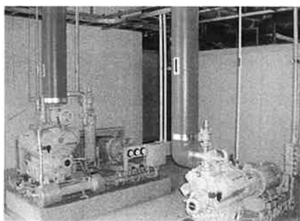
17.製氷機用圧縮機(左) 貯水庫・冷蔵庫用圧縮機(右)
