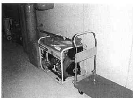
23.バッテリーチャージャー、空気 圧縮機、溶接機付発電器、台車他
