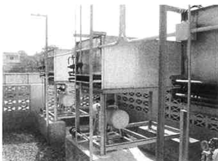
16.冷凍庫用コンデンサーユニット
