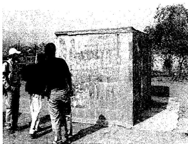
番号：IMG2671 日付：2月20日 場所：マントンパ 北緯： 東経： 標高： 備考：学校の給水タンク、接続が壊れている。
