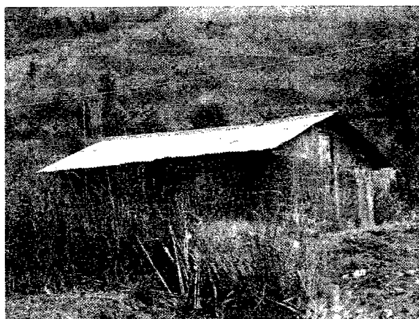
番号：IMG2670 日付：2月20日 場所：マントンパ 北緯： 東経： 標高： 備考：放置され使用されていない給水タンク
