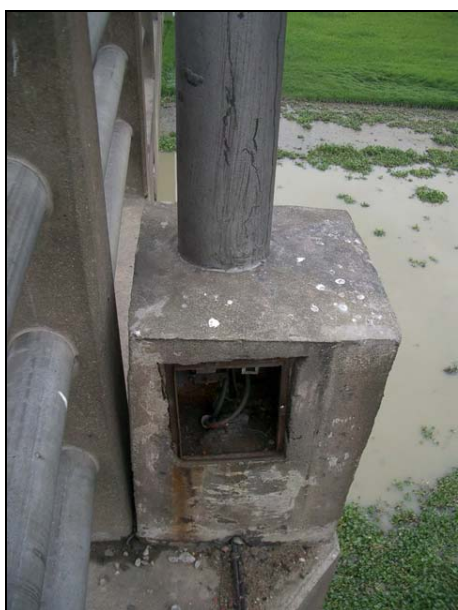
写真 2-5 照明の配線は切断され、夜間の照明は機能していない。(メグナグムティ橋も同様である。)
