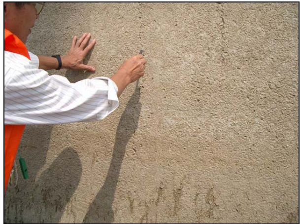
写真 1-4 橋脚にヘアクラックが見受けられる。
