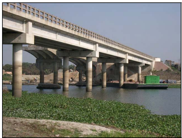
写真 3-5 バティヤチャー橋。4 車線化のため ADB が平行して橋梁を建設中である。
