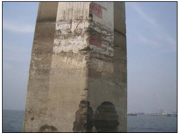
写真 1-2 船舶の衝突によるものと考えられるコンクリートの剥離
