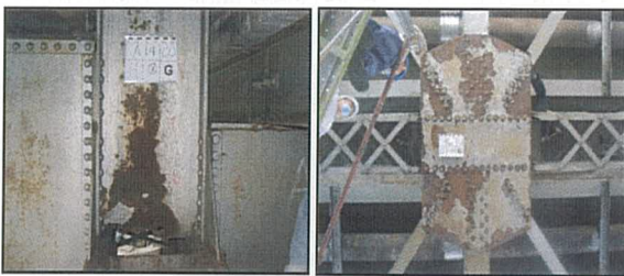
腐食した鉛直吊材
