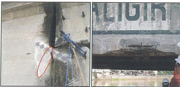
ゲルバーヒンジでのクラック
