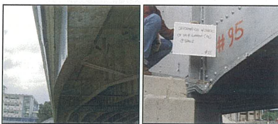
船舶の衝突による外桁の破損
