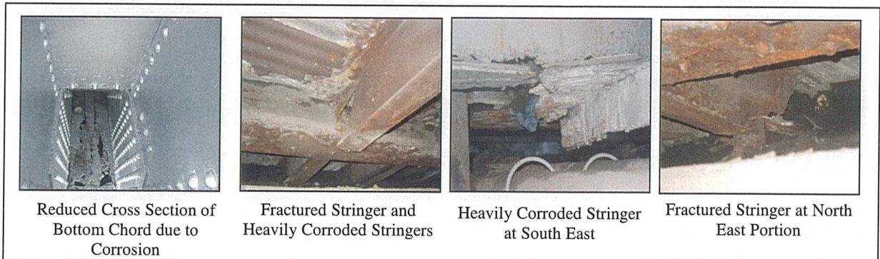
代表的な損傷
