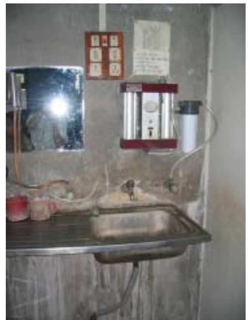
老朽化した給排水設備
