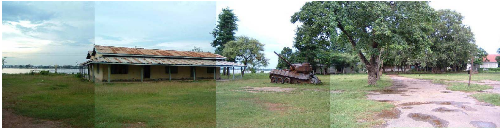
大講堂棟：老朽化が非常に激しく、現在は使用されていない。本件では相手国負担工事で取り壊し、新教室棟の建設予定地とする。
