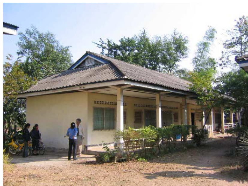
実習室・女子寮棟：屋根等が劣化しており、本件で改修を行う。
