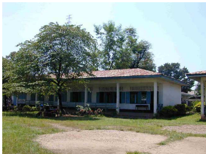
教室棟：壁面にクラックが見られる。本件で改修予定。
