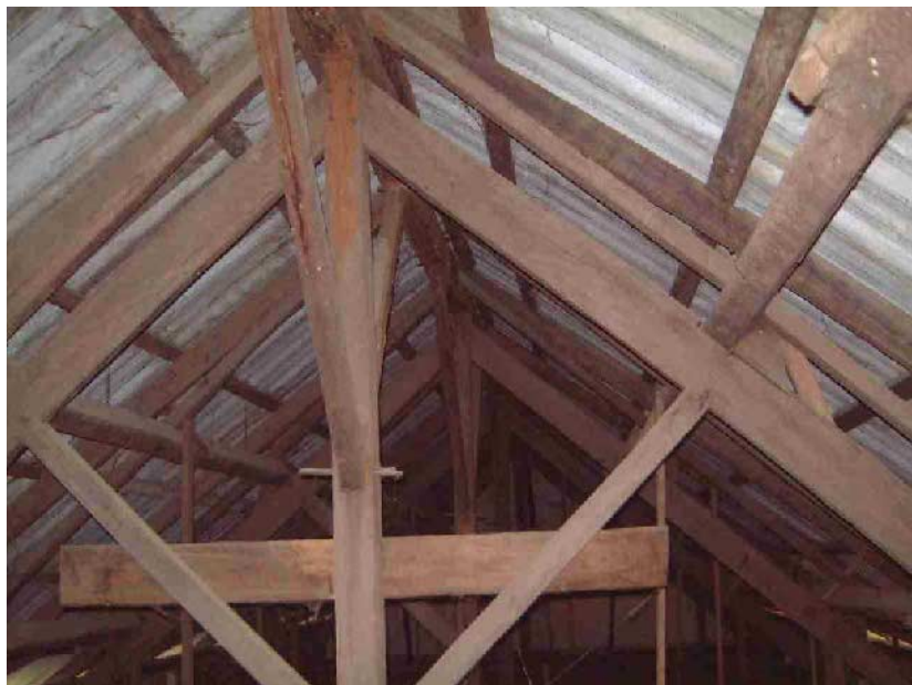
教室棟小屋組：一部シロアリにより腐食している。
