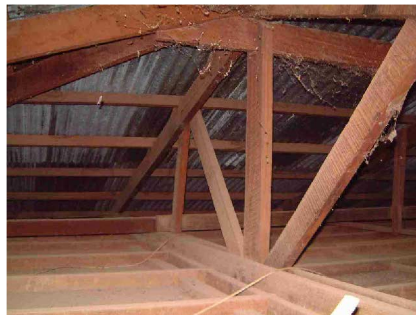
教室棟小屋組：蟻道があり、腐食が進んでいる。
