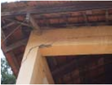
同・亀裂の入った柱・梁
