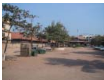
計画施設の建設予定地 解体撤去対象の老朽校舎は、上部躯体のみ撤去済み。基礎部分は残存。
