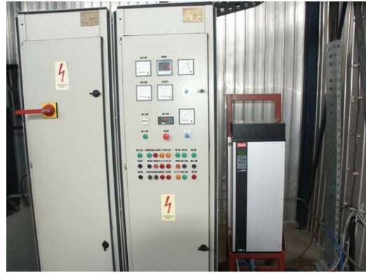
Reny Well 内部 (制御装置)
