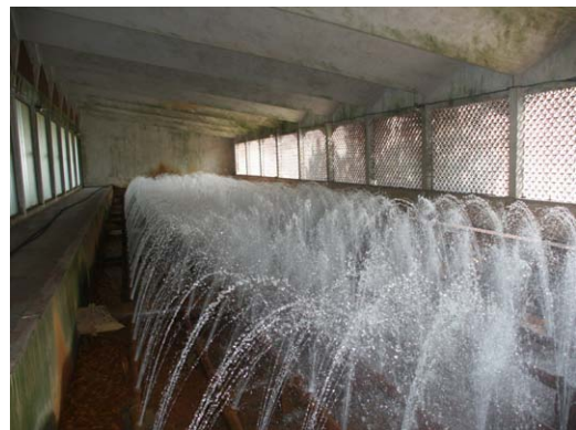
ベザニヤ浄水場 (エアレーション)
