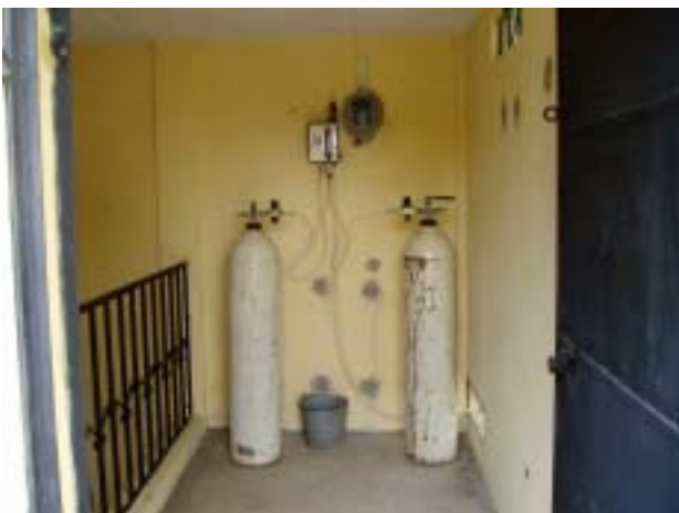
サンイシドロ配水池滅菌設備 湧水からの導水管に塩素注入されている。
