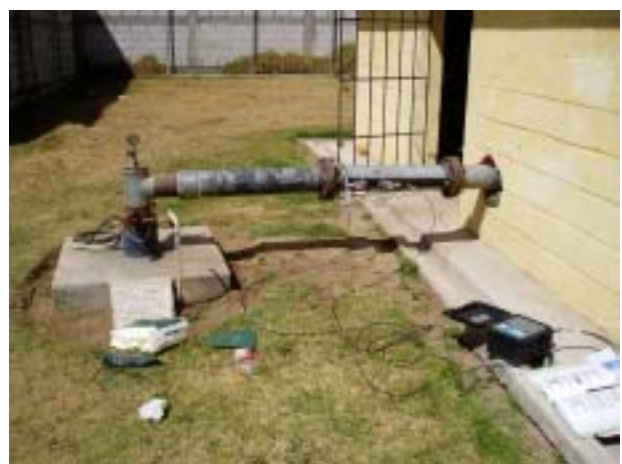
井戸デモクラシア (2002 年建設) 井戸深 139m、口径 \phi 200mm、揚水量 26 ㍈/秒。揚水量を超音波流量計を使用して計測。
