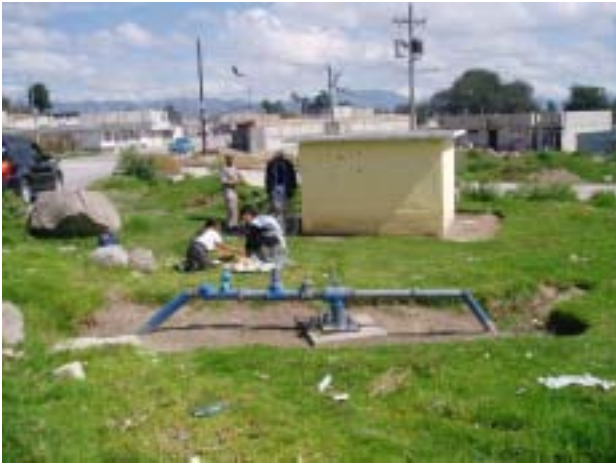
井戸ラスアメリカス (1989 年建設) 井戸深 152m、口径 \phi 200mm、揚水量 15 ㍈/秒。現在は本井戸を水源とした直接配水の独立配水区を持つ。計画では本井戸からサンイシドロ配水池まで約 4km の送水を行う。
