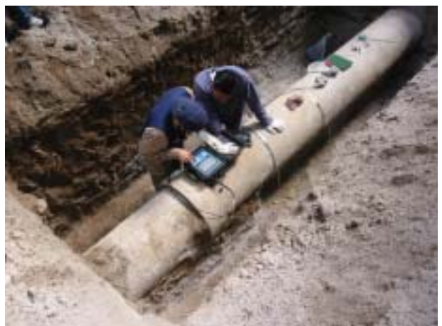
超音波流量計による流量測定風景 湧水導水管トンネルの入口、出口の両地点において流量計測を実施。トンネル内の漏水が無いことが確認された。
