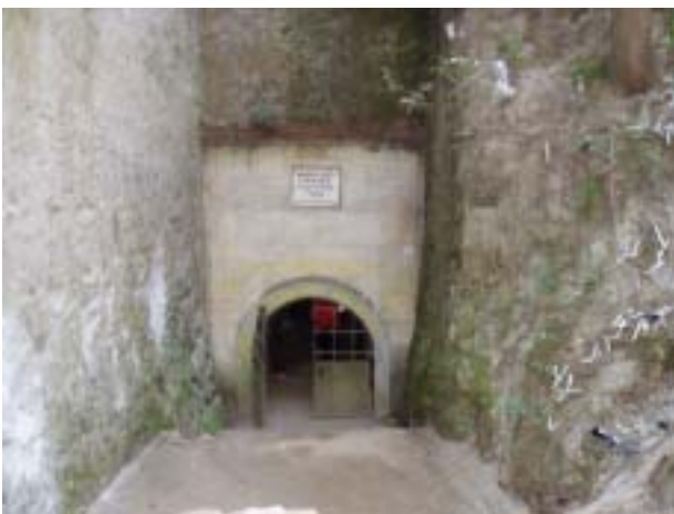
湧水導水路トンネル入口 全ての湧水は合流した後、延長約3.8kmのトンネル内に布設されたACφ450mmによってサンイシドロ配水池へ導水される。
