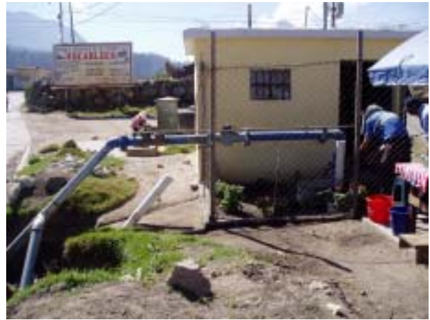
井戸バカハ (1997 年建設) 井戸深 183m、口径 \phi 200mm、揚水量 18 ㍈/秒。地区委員会から EMAX に移管され、本井戸の独立配水区を持つ。揚水量を 35 ㍈/秒に増産するため、ポンプの更新を計画する。
