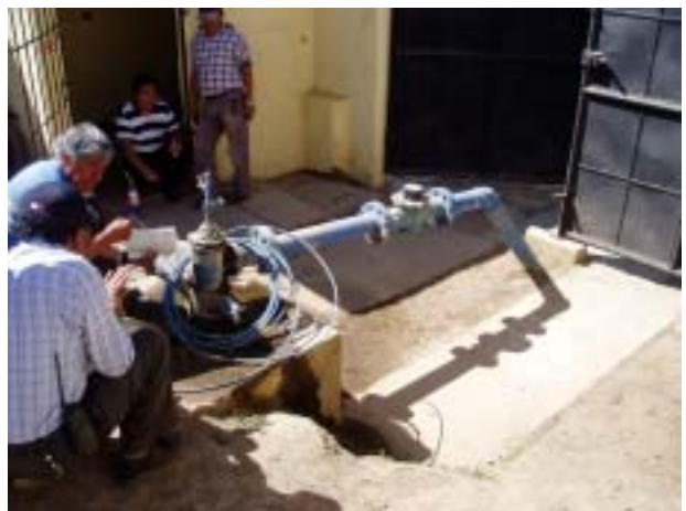
井戸エルパライソ 井戸深 67m、口径 \phi 200mm、揚水量 22 ㍈/秒。本井戸の独立配水区を持つ。計画ではサンイシドロ配水池までの送水を行う。
