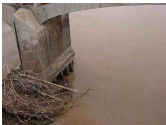
写真9：ダム下流の洗掘状況
