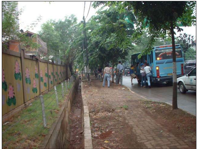
Photo 2.4 Kondisi Trotoar yang Rusak
