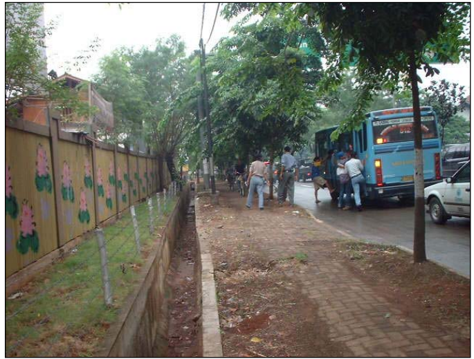
写真 2.4 損傷の激しい歩道
