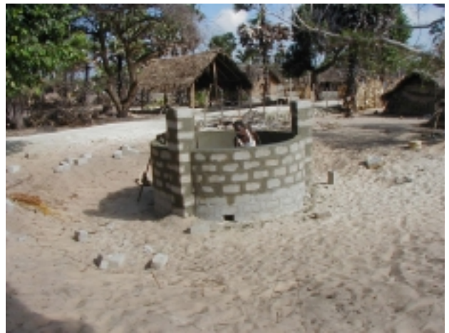
公共井戸の建設。現在は、各世帯が自力で井戸を掘り生活用水を確保しているが砂地のためセメントを利用しないとすぐに埋まってしまうとのことだった（マンタイ西部郡）
