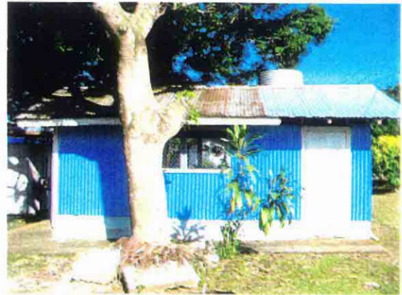
観光・接遇科教室。住宅に付随した倉庫を改装している為、環境が悪く、手狭である。
