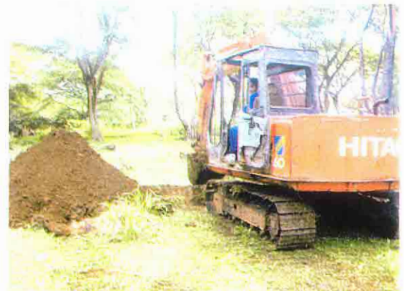
地質調査立会い。掘削及び貫入試験を実施し比較的浅い2.0m前後に岩盤を確認した
