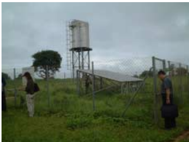
Bakendick : EDF ソーラー揚水システム ( 1.4kw , 32m 3 / 日 )
