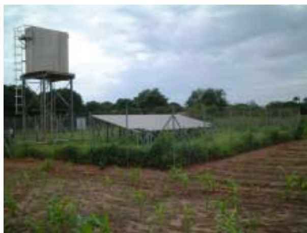
Medina Sedia : EDF ソーラー揚水システム (2.7kw , 54m 3 / 日)
