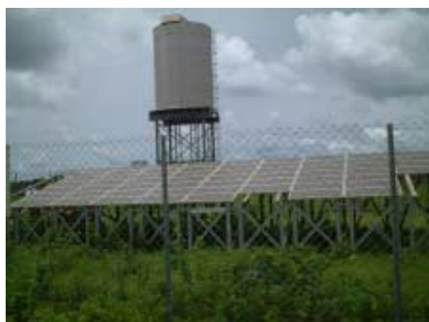
Pirang : EDF ソーラー揚水システム (3.8kw , 75m 3 / 日)
