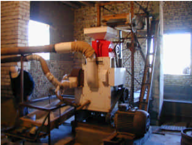
2KRにて供与された精米機 KRセンターよりファーマータイプ農場主が借り受け、 周辺住民より精米料を徴収して精米している。 ホレズム州 クシクピル地区にて
