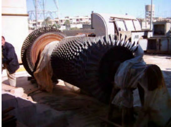
撮影 2003年3月 モスルガスタービン発電所 (1号機ローター) ローター損傷のため、停止中。
