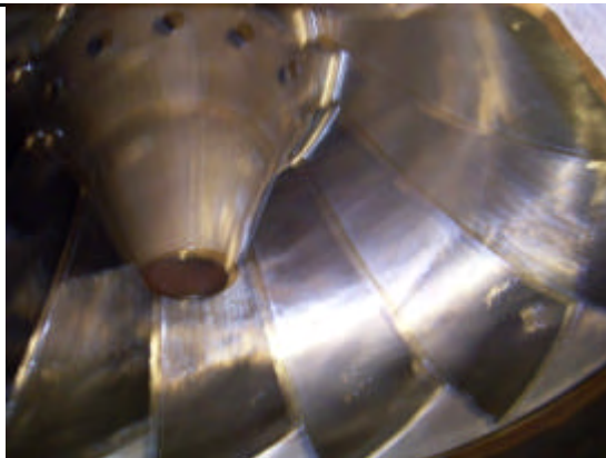
モスル水力発電所 キャピテーションがみられるランナー。
