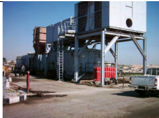
撮影 2003年3月 モスルガスタービン発電所 (4号機) 10MW出力で稼働中。
