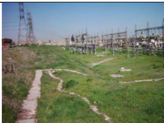
撮影 2003年3月 モスルガスタービン発電所 132kV送電線と変電所
