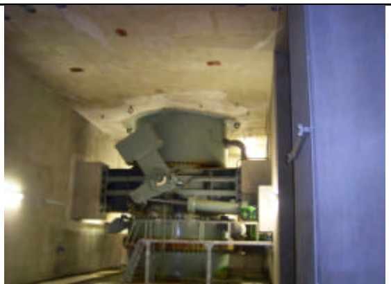
モスル水力発電所 開閉不能な 3 号機用の鉄管ゲート弁。
