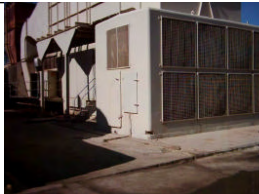
撮影 2003年3月 モスルガスタービン発電所 (3号機) 使用不能のため、他社の中古と取替えされている。
