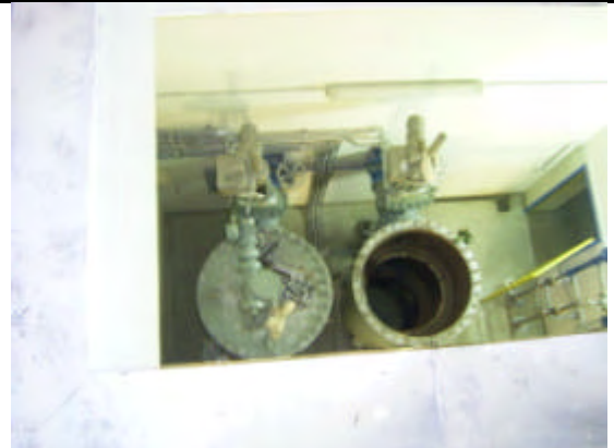
モスル水力発電所 部分改修が必要なウォーターストレーナー。
