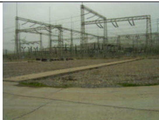
モスル水力発電所 一部、改修が必要なモスル水力発電所のスイッチヤード
