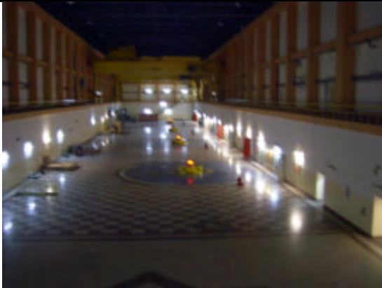
モスル水力発電所 建屋内部。
