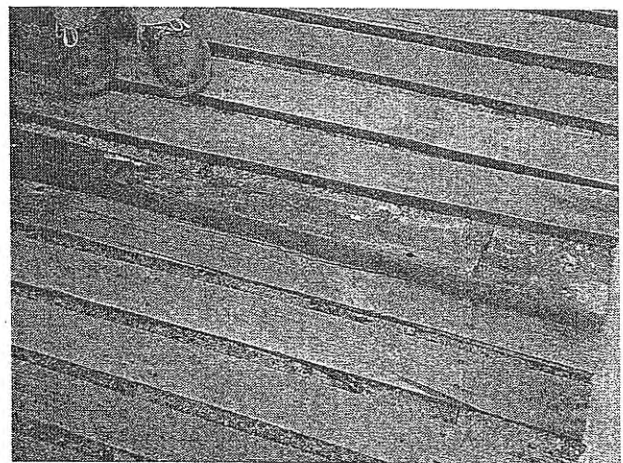
スペインビジターセンター 木材の反りで、修理・補修が必要である。電圧変動も大きく、電球の交換が月あたり30個とのこと。
