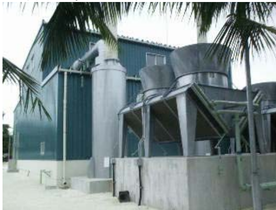
4号発電設備の補機
