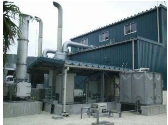
廃油焼却炉と雨水貯蔵タンク
