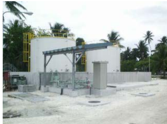
燃料貯蔵および移送設備
