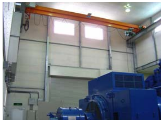
発電所建屋内のクレーン
