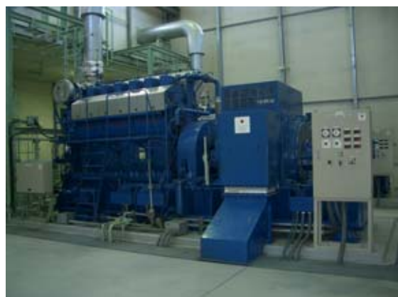
3号発電設備と東側壁
