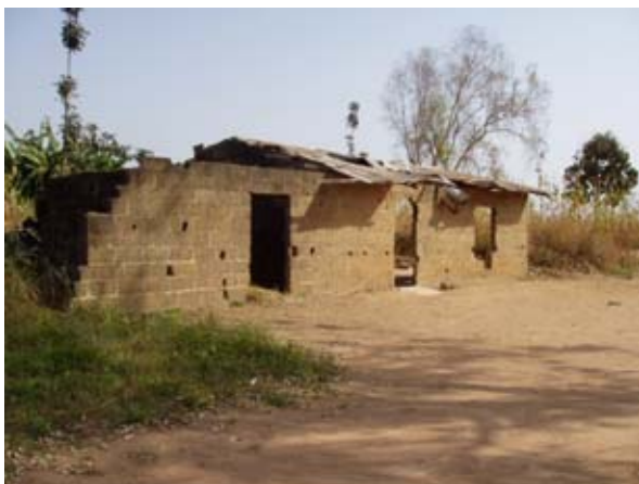
Ung. Rana Baduna 校： 屋根・壁が崩れており、危険な状態で授業が行われている。
