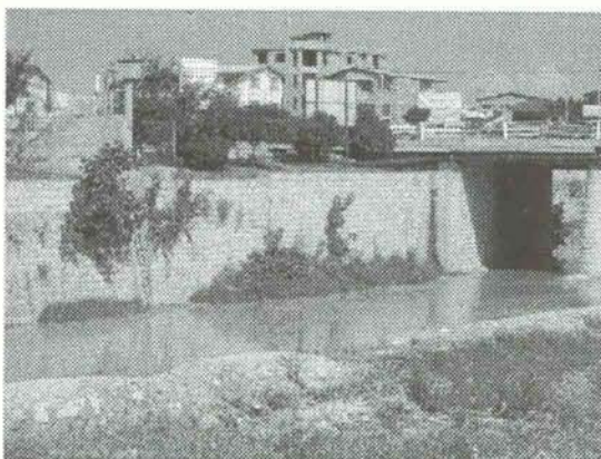
写真 2-5 ネッカ市中心部の橋梁、 洪水はこの橋を越流
