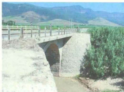
マダルス川下流の洪水時に流された橋 (現在は復旧済み)
