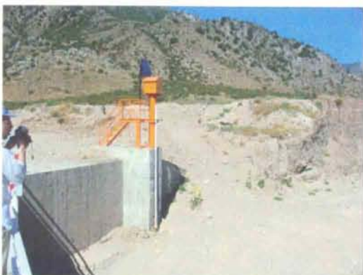
マダルス川に洪水後に設置された水位計 (ゴレスタンの森東端)
