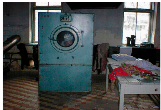
老朽化した洗濯用乾燥器
