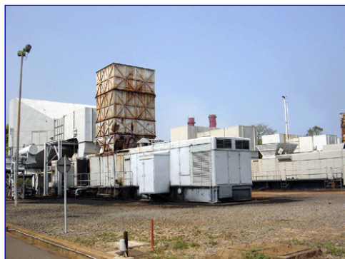
20 MW ガスタービン発電ユニット (6ユニットの内の1ユニット)
