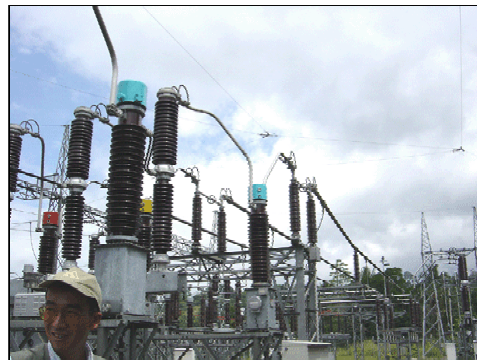
アルミニウム管を使った132 kV単母線のKiribathkumbura変電所 (Kandy)
