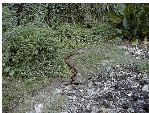
改善前の浸出水流出状況
