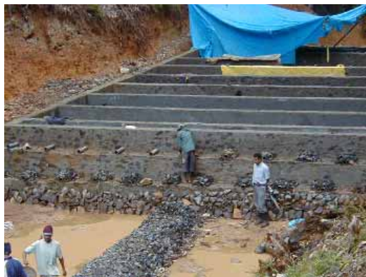
浸出水収集施設と処理池の接続部
