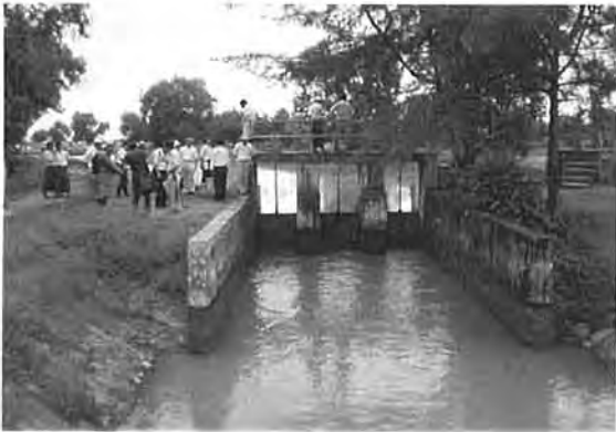
現地調査③ 分水施設
