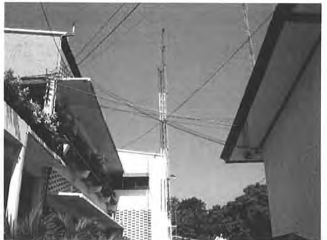
テレメータシステムデータ送信用アンテナ
