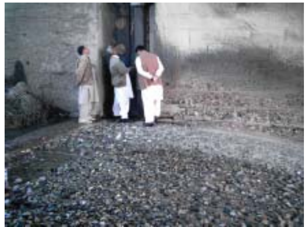
10 Gate クレスト磨耗状況
