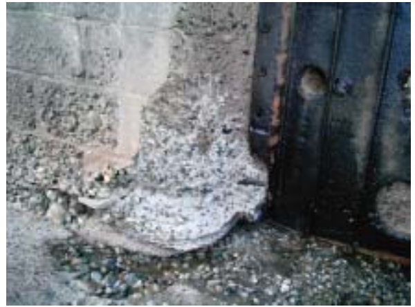
8 Gate 下部における磨耗状況
