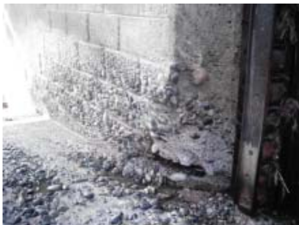
11 Gate 橋脚部磨耗状況
