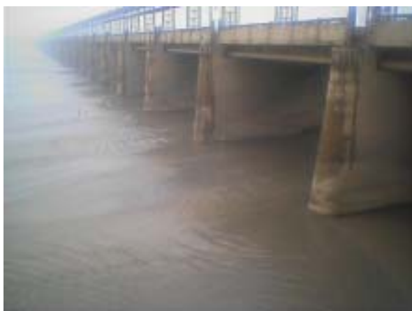
29 Gate 上流の流下状況
