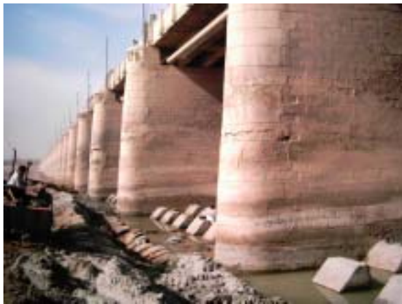
15 橋脚部のハクリ状況
