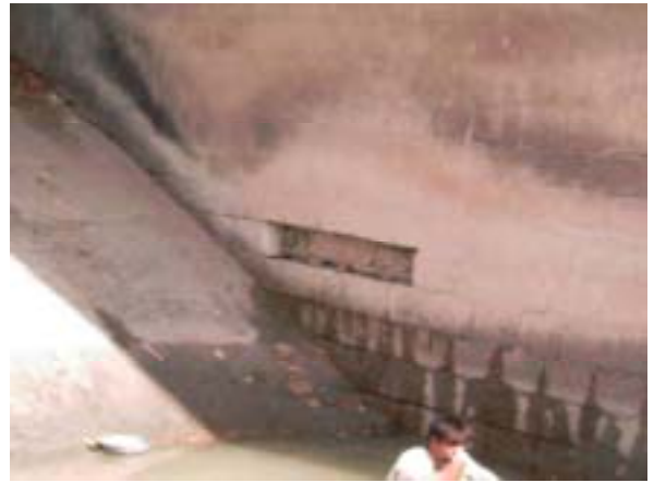
14 橋脚部のハクリ状況
