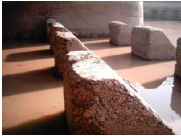
7 フリクションブロックの磨耗状況
