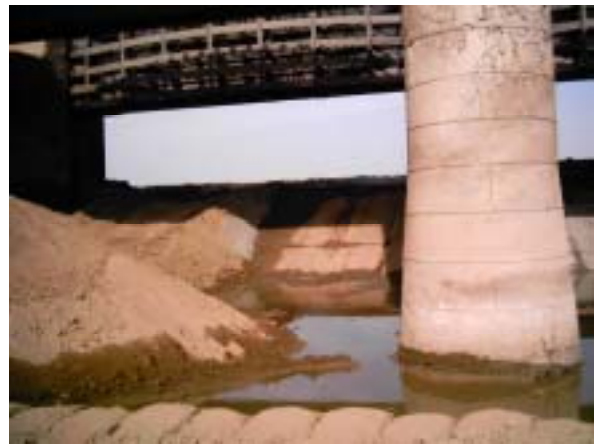
16 橋脚部のハクリ状況
