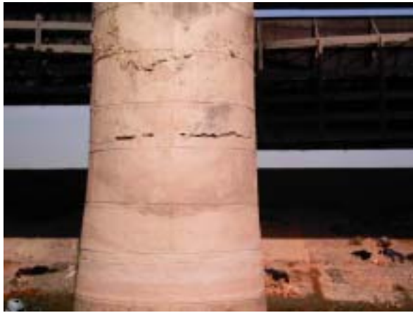
13 橋脚部の水平クラック状況
